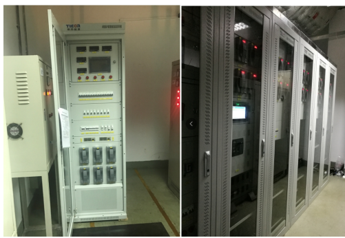
③轨道交通应用案例 广州地铁西门站屏蔽门驱动/控制电源系统
