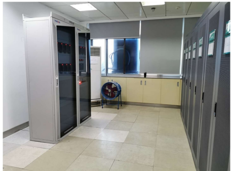
⑥并联通信电源应用案例 江苏信通公司南京老大楼通信机房
