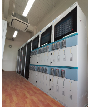
②全模块化应用案例 上海浦东董香110kV输变电工程
