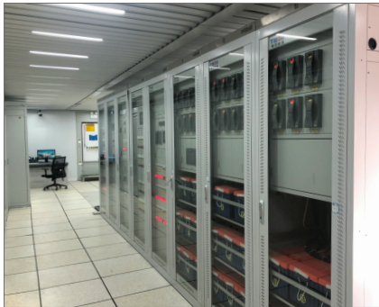
⑤钢铁行业应用案例 韶钢钢铁110kV炼钢变电站
