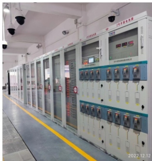
2.变电站模块化直流电源系统
