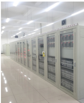
1.变电站直流电源系统
